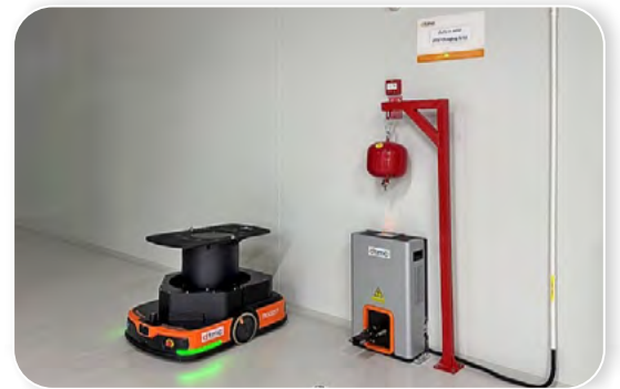
黃石廠導入無人搬運車 AGV 運送產品，減少人工搬運台車產生的工安風險。
